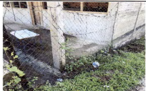
Foto 10: Malla demasiado destruida.
