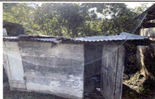
Foto 4: Estructura de madera en pésimas condiciones.
