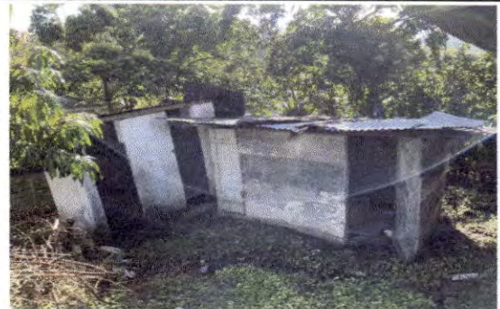
Foto 8: Servicios sanitarios en pésimas condiciones.
