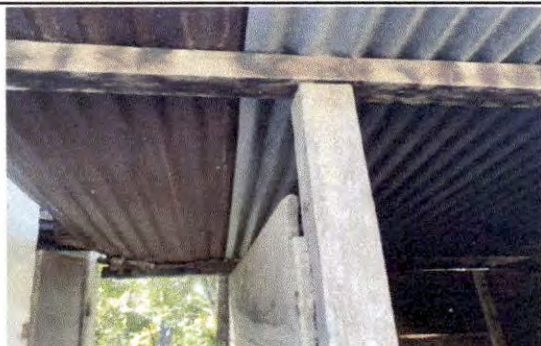
Foto 3: Láminas en mala condición.
